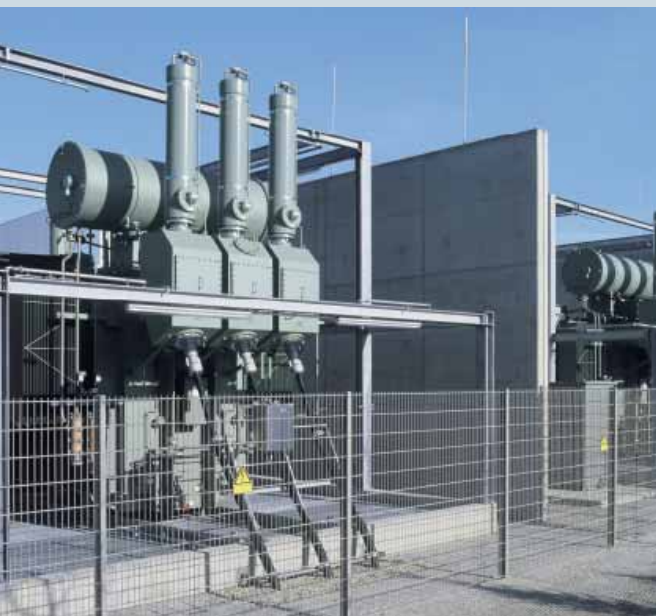
Элегазовые ОПН, установленные на трансформаторе напряжением 123 кВ с проходным изолятором типа «масло – элегаз (SF 6 )»
